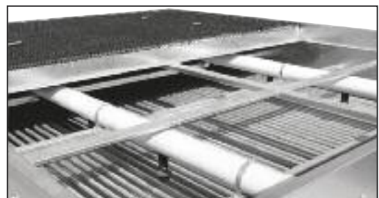
Éliminateurs de gouttes démontés pour l'inspection de la distribution d'eau
