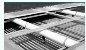
Entfernte Tropfenabscheider zur Inspektion des Wärmeübertragers
