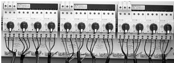
Motorschutzschalter im Schaltkasten
